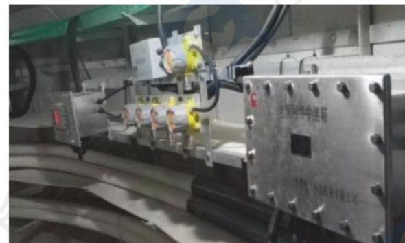
通道综合监控
