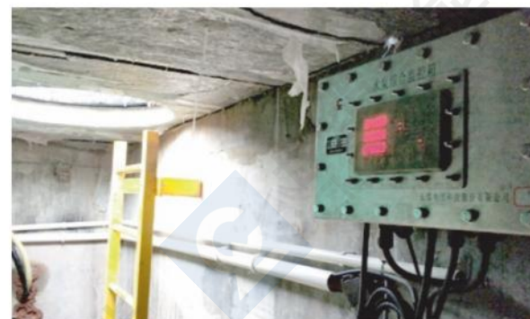
水泵综合监控箱
