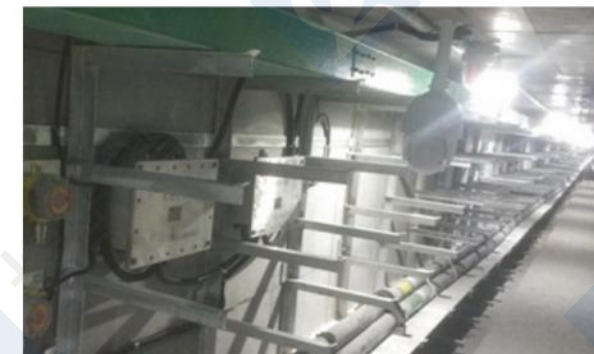
通道综合监控
